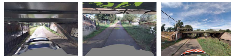
De huidige situatie van de onderdoorgang onder het spoor laakt kwaliteit en wordt als sociaal onveilig ervaren.
